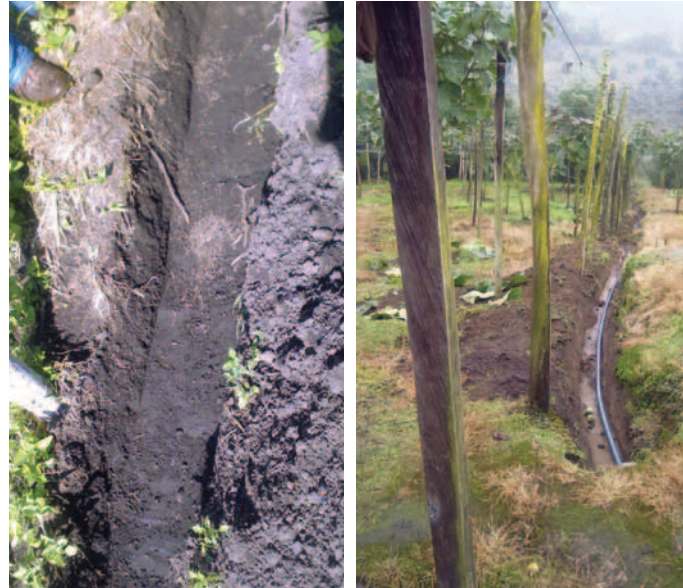
Figura 17. Manejo preventivo de la pudrición de raíz mediante la elaboración de zanjas. Fuente: Alarcón, 2012.
